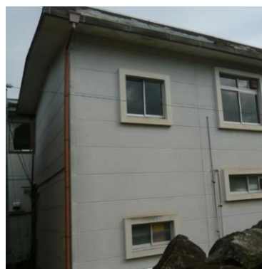
屋根の劣化が著しい別館1屋根
