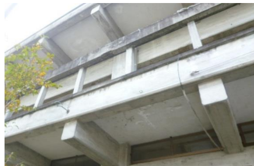
バルコニー手摺の破損（本庁舎）
