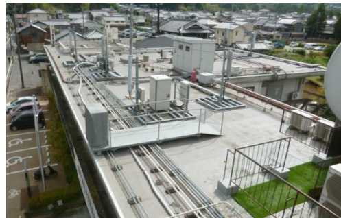
屋上に設備機器が多く見られる（本庁舎）
